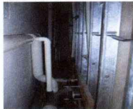
检修夹墙内管线布置
